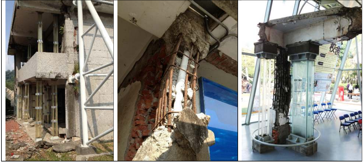
Şekil 5. Hasarlı okul binasının güçlendirilmesi ve hasarlı yapı elemanlarının sergilenmesi
